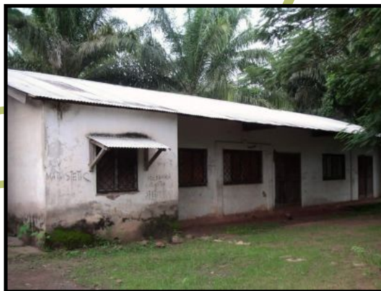
Imagen del deterioro de los antiguos edificios de la misión
