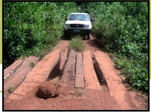
Este es el estado de los puentes a reparar
